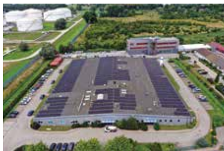
TSTRONIC sp. z o.o., Gdańsk, elektrownia fotowoltaiczna na dachu zakładu, wykorzystywana na potrzeby własne.
